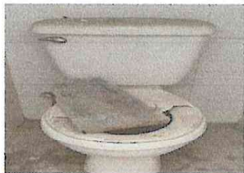
Foto 1: Servicios sanitarios y sus accesorios
